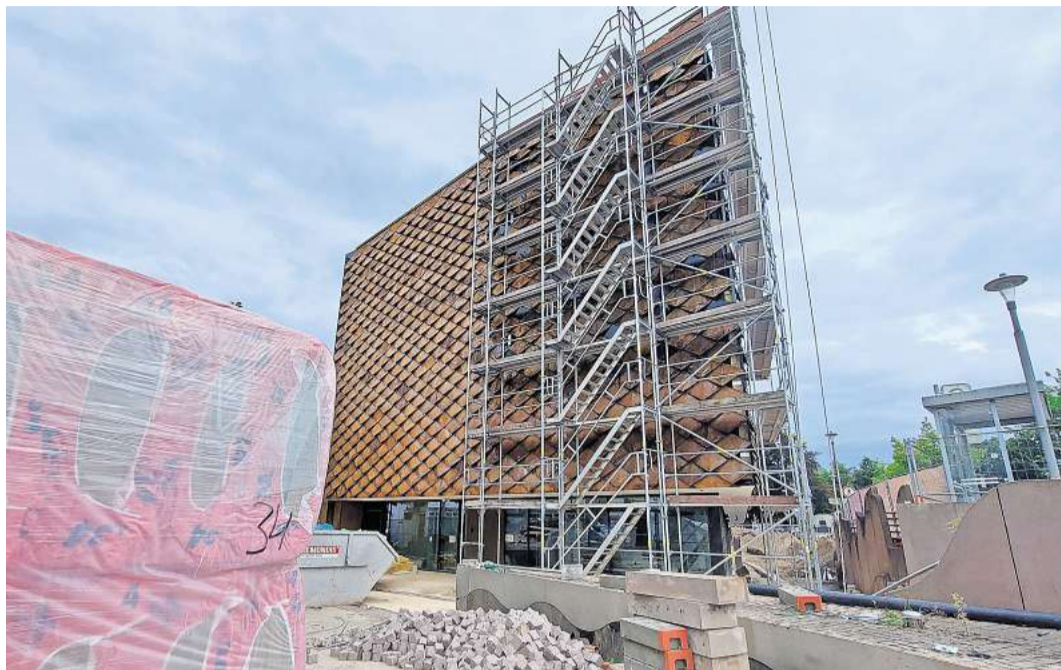
Noch Baustelle, bald hoffentlich Anziehungspunkt für Touristen: Sensoria in diesen Tagen. THOMAS SPECHT
